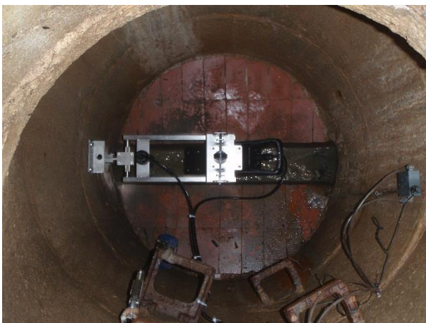
Mengenmessung in Abwasserübergabestation
