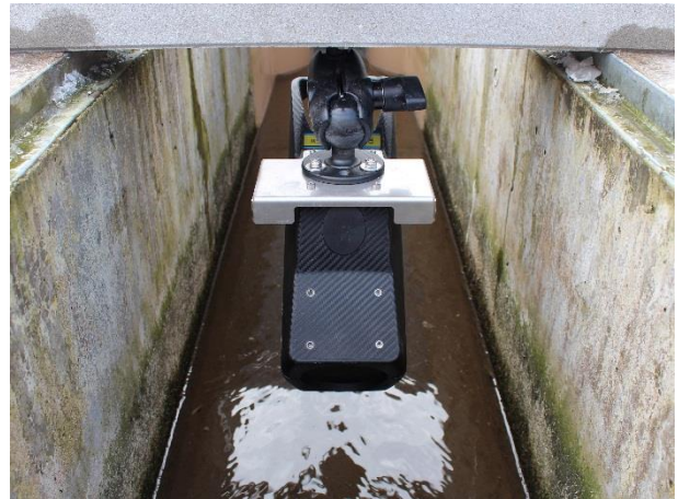
Rechteckgerinne am Kläranlagenzulauf
