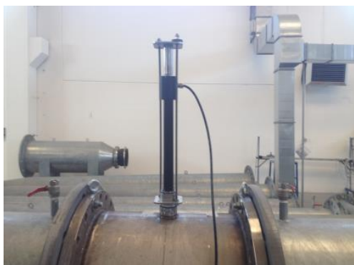
LANZEN-MID DN700 in Rohrleitung
